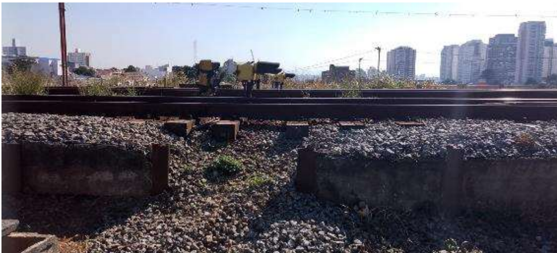
Figura 8 – brita insuficiente sob o bonde de impedância. Fonte: CPTM
