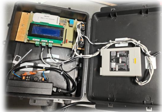
Figura 8 - Caixa de Monitoramento.
