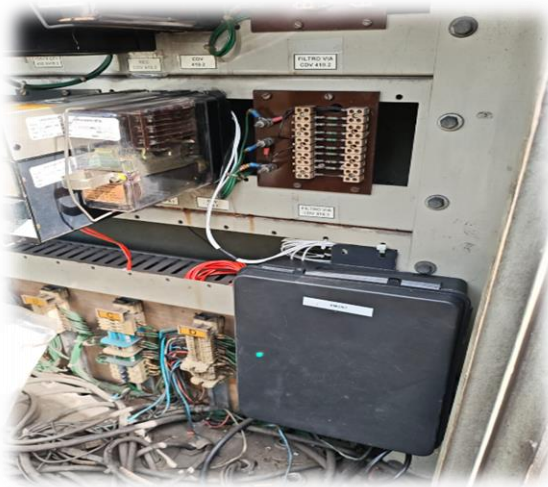
Figura 9 - Equipamento instalado em campo.
