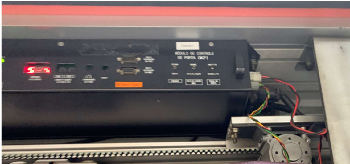
Figura 2 — Módulo de Controle de Porta (MCP): emite os códigos de estado/falha registrados nos logs do Pannel de Comando Centralizado (PCC). Fonte: Autoria própria
