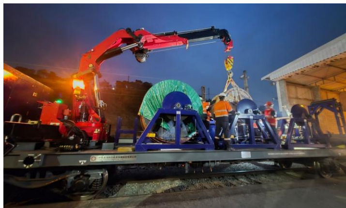
Figura 19 - Bobinas sem alocadas nos bobineiros
