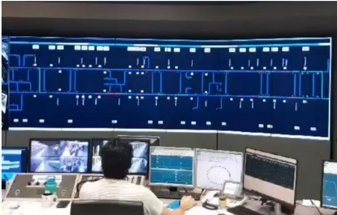
Figura 1 – Ambiente do Centro de Controle Operacional e painel de monitoramento de trens. Fonte: Metrô de São Paulo / acervo do projeto
