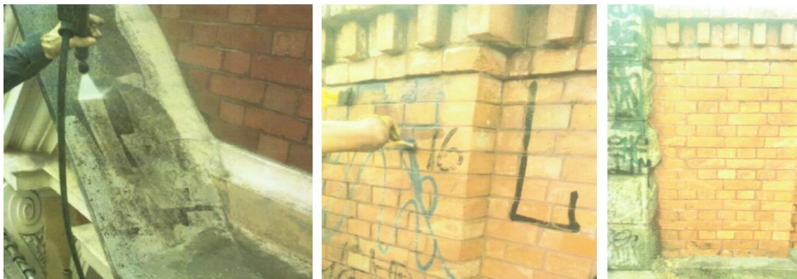
Figura 4 - Mosaico fotográfico de patologias. Crostas negras nos torreões a esquerda, impregnação de tinta spray e perda de seções nos tijolos ao meio, e a direita depósito de tintas e crostas nas cantarias. Fonte: Arquivo Sarasá (2022).
