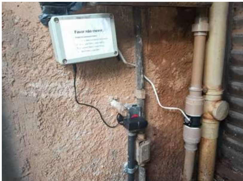
Figura 5 – protótipo de dispositivo medidor instalado na estação piloto. Fonte: Arquivo Pessoal
