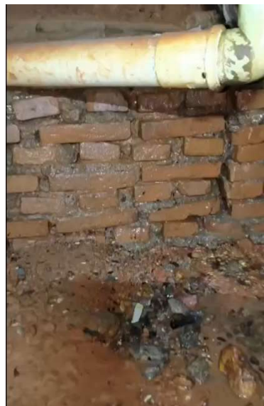
Figura 8 – Vazamento subterrâneo detectado na estação piloto com a ajuda dos dados obtidos. Fonte: Arquivo Pessoal
