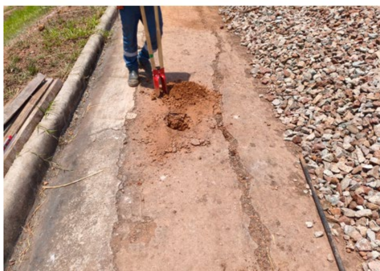
Figura 12 – Contexto da investigação no km 730: (a) trincas observadas no trecho; e (b) Levantamento GPR com Detector Duo para verificar extensão das trincas.
