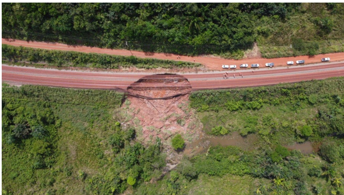
Figura 8 – Fotografia aérea da área mais alterada do trecho 378, onde há uma cratera abaixo da linha férrea. Esta cratera está exatamente em 378+100.
