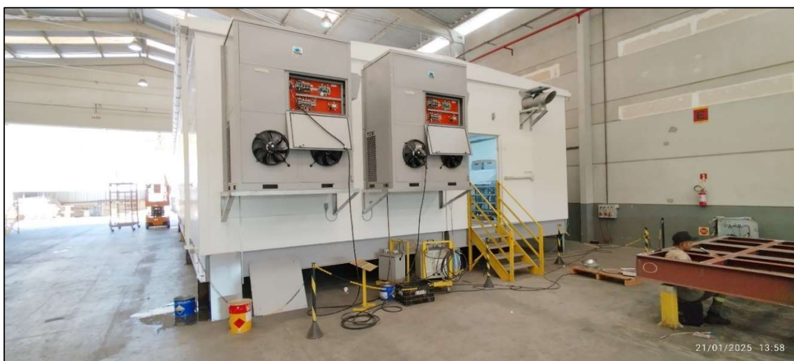
Figura 13 – Inspeção em fábrica do eletrocentro da Subestação
