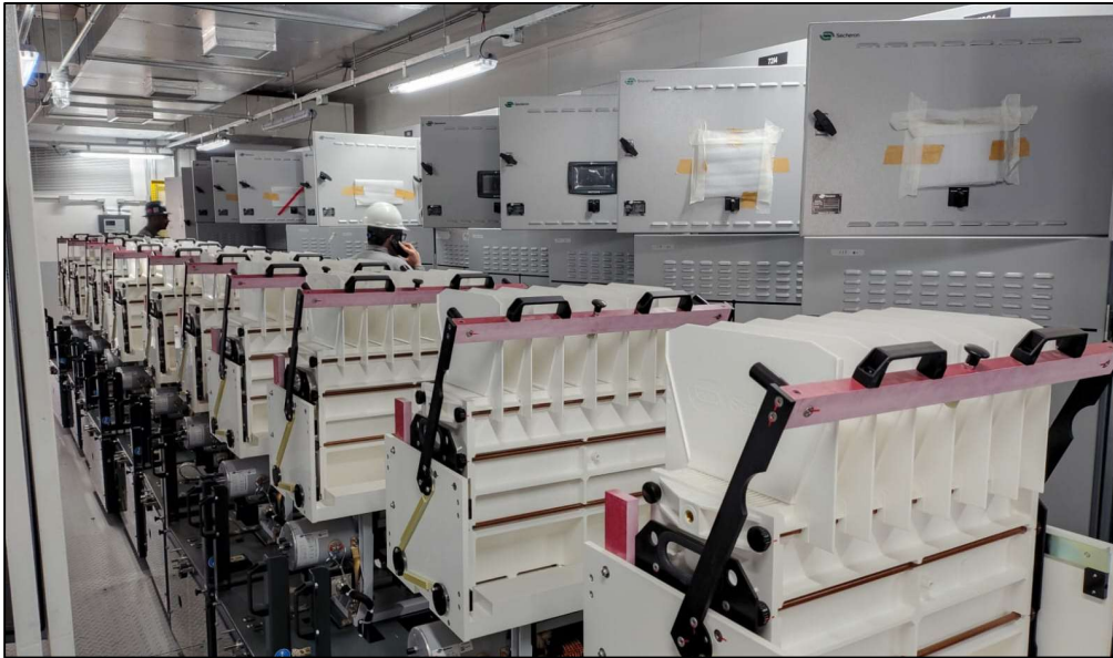
Figura 25 – Verificação dos cubículos de disjuntores de tração
