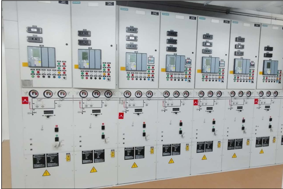
Figura 6 – Cubículos de 34,5 kV isolados a gás
