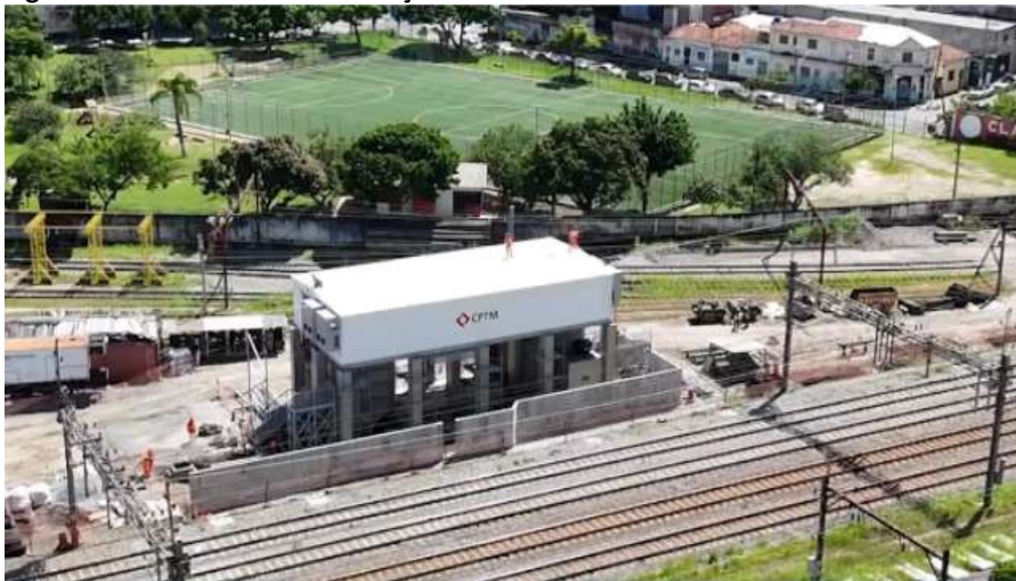
Figura 1 – Vista aérea da subestação Memorial da América Latina
