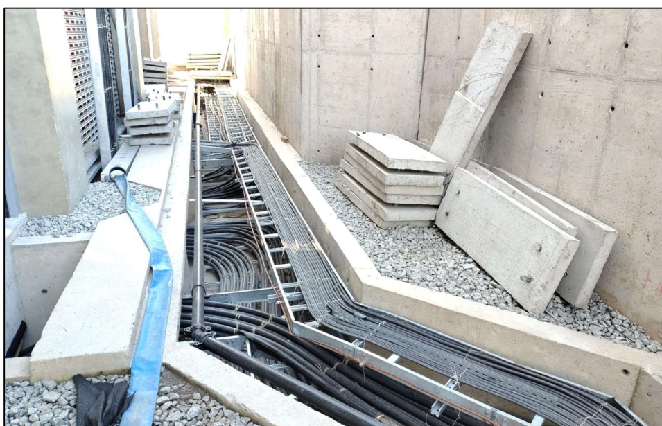
Figura 23 – Canaleta de cabos da subestação
