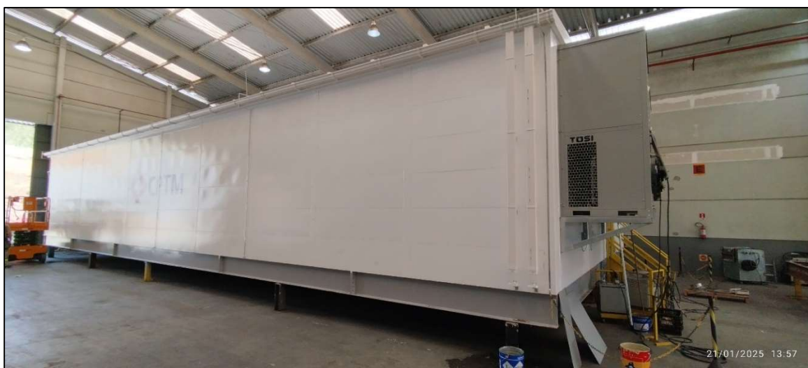
Figura 12 – Inspeção em fábrica do eletrocentro da Subestação
