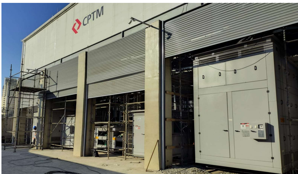
Figura 3 – Vista do pavimento térreo da subestação Memorial da América Latina Detalhe dos transformadores a seco (encapsulados)
