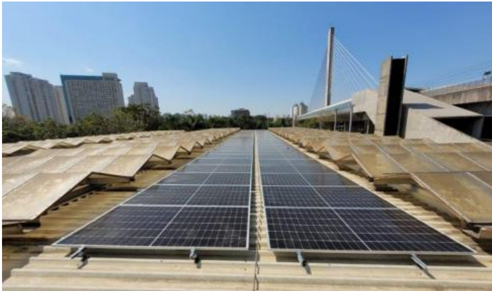
Figura 2. Imagem do Sistema Instalado.
