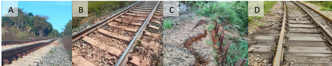
Figura 13 – (A) Exemplo desnivelamento do trilho, região com solo de baixa capacidade de suporte e elevação do lençol freático (B) Exemplo de lastro contaminado, região com solo com elevação do lençol freático (C) Exemplo de solo com alto grau de erodibilidade (D) Exemplo de bombeamento, região de solo com alto grau de erodibilidade. Fonte: Autoria dos autores
