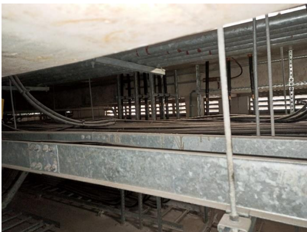
Figura 16 - Porão de Cabos da SE Ayrton Senna
