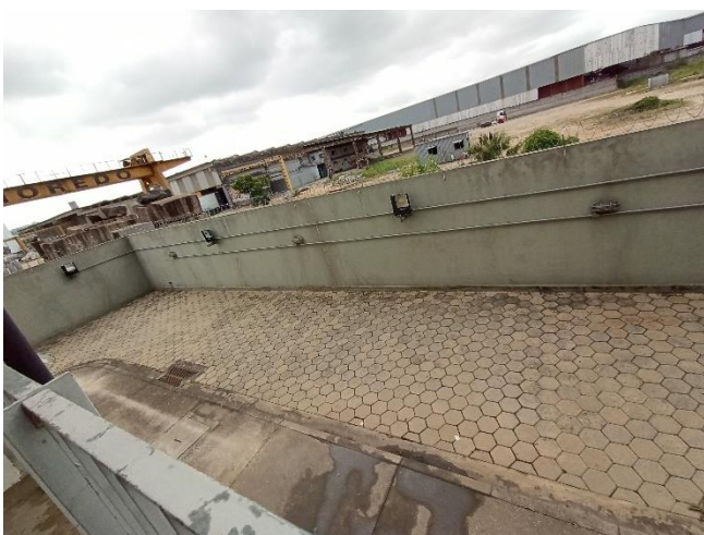
Figura 18 - Área externa - local de instalação 2
