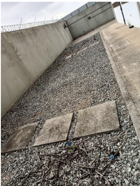
Figura 17 - Área externa - local de instalação 1
