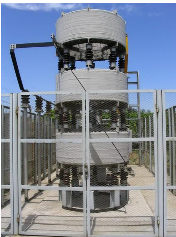
Figura 11 - Exemplo de reator shunt do tipo seco. Fonte [22].
