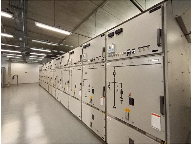
Figura 13 - Linha de Cubículos 34,5kV existentes
