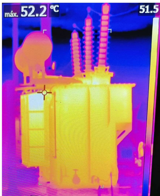
Figura 18 - Inspeção termográfica do transformador com corrente nominal
