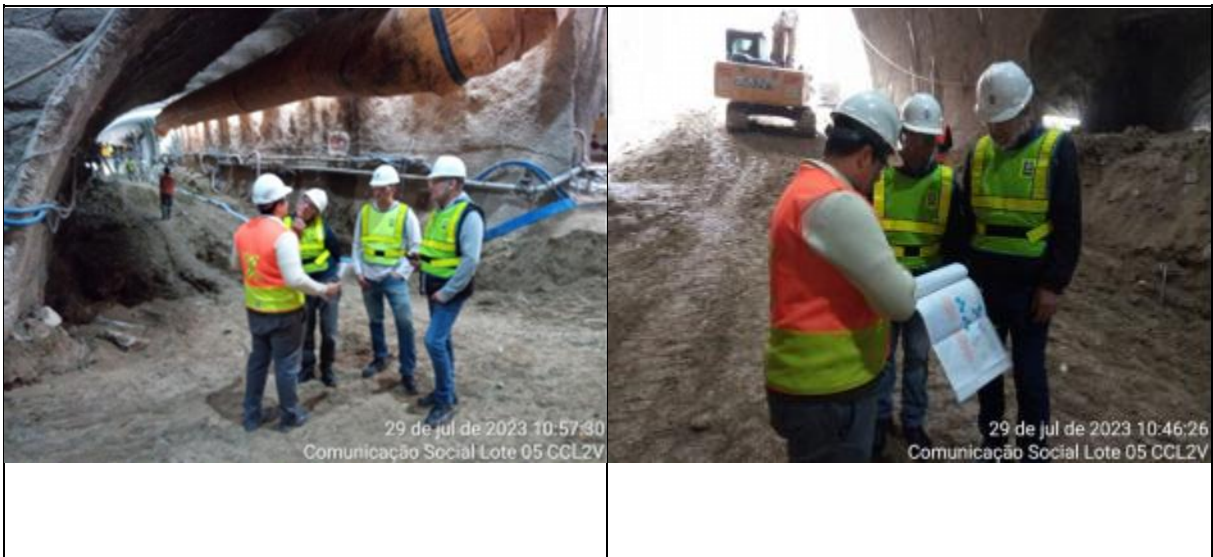
Foto 15 e 16 - Registro da visita dos moradores na Obra de Santa Isabel equipe de engenharia e comunicação social realizando atendimento.
