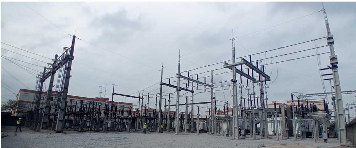
Figura 1 – Subestação Cidade Dutra
