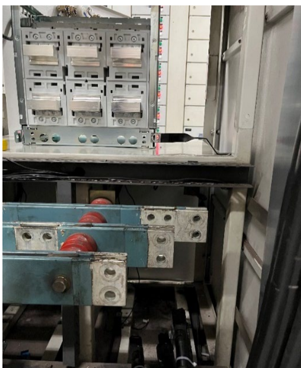
Figura 29 – Detalhe dos barramentos do novo disjuntor da entrada 1 (QPD) em instalação. Perceba que as furações de saída do 3WL não estão simétricas em relação aos barramentos de distribuição (abaixo, na horizontal)
