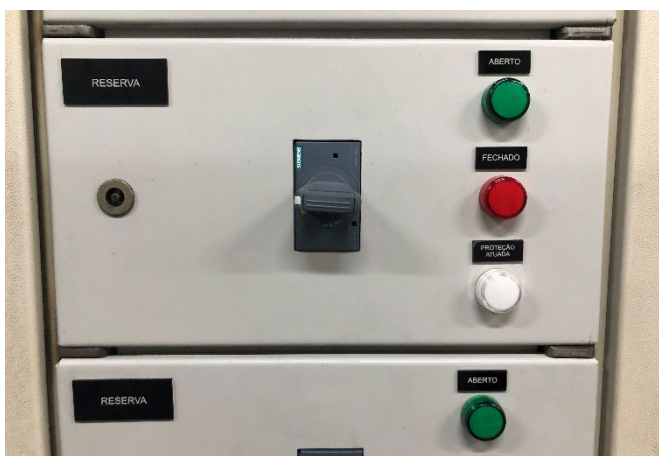
Figura 15 – QDGF: Vista frontal da modernização (nova gaveta com disjuntor de caixa moldada SIEMENS modelo 3VM) no seu compartimento/cela
