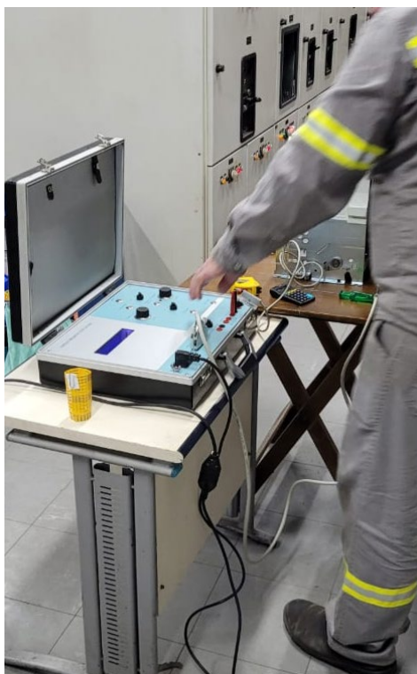
Figura 42 – Comissionamento em campo (estação Santa Cecília) com a utilização da mala de testes da ETU Siemens 3WL
