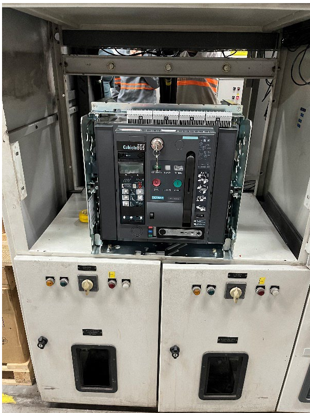
Figura 8 – Detalhe da modernização com novo disjuntor SIEMENS 3WL (3200 amperes)
