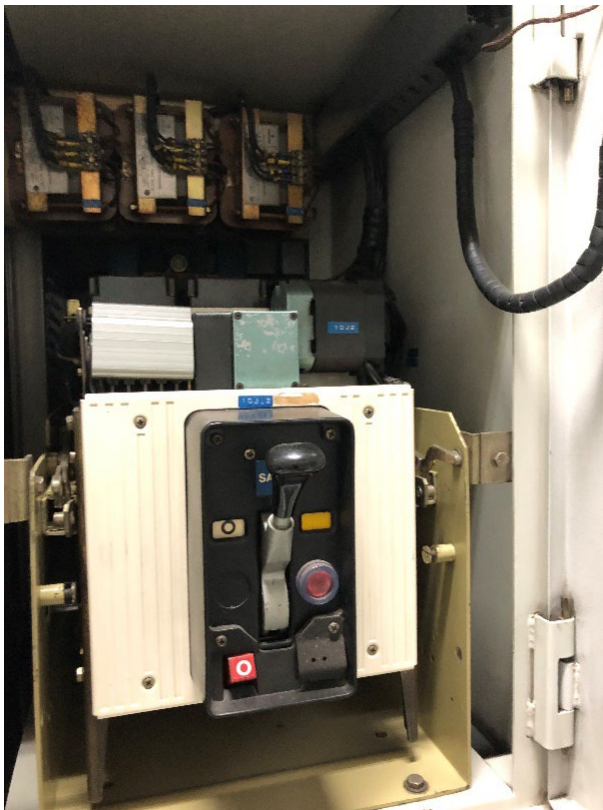
Figura 5 – Vista frontal do disjuntor (antigo) de Caixa Aberta SACE Novomax (800 amperes)
