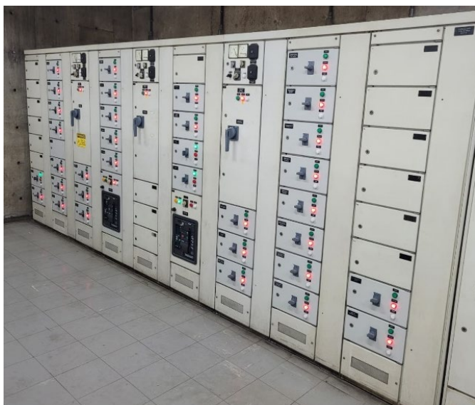
Figura 17 – QDGF: Vista externa do quadro já modernizado, com as 36 novas gavetas com disjuntores de caixa moldada, substituindo as seccionadoras com fusíveis
