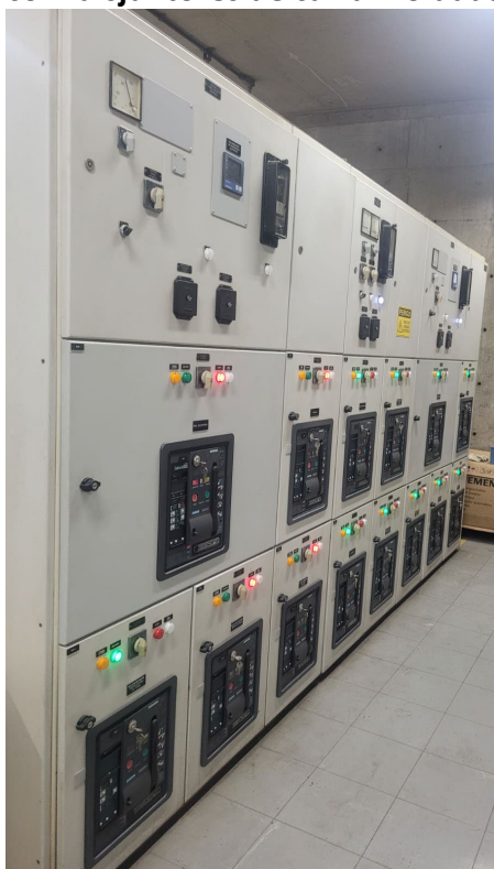
Figura 18 – QPD: Vista externa do quadro já modernizado, com 14 novos disjuntores
