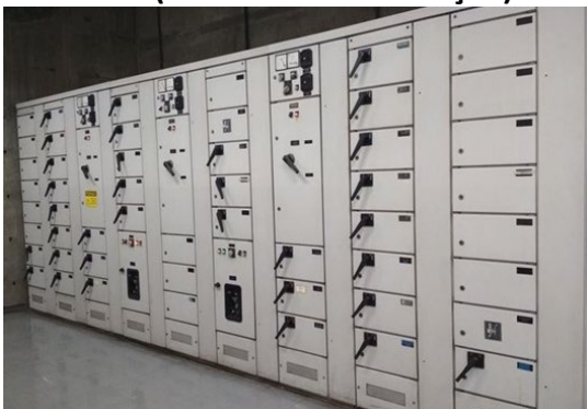
Figura 2 – Quadro de Distribuição Geral de Força 460VCA (QDGF) da estação Santa Cecília L3-Vermeha (antes da modernização)
