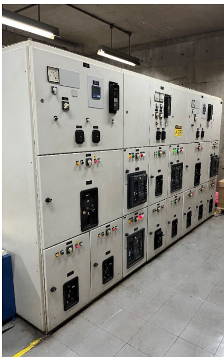
Figura 3 – Quadro Principal de Distribuição 460VCA (QPD) da estação Santa Cecília L3-Vermelha (em processo de modernização)
