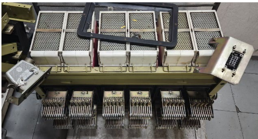
Figura 37 – Disjuntor antigo (SACE Otomax de 3200 amperes) removido que, agora, virará sobressalente estratégico para o restante da Linha 3-Vermelha.
