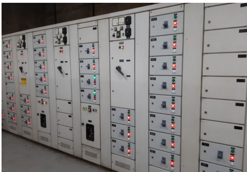
Figura 4 – Quadro de Distribuição Geral de Força 460VCA (QDGF) da estação Santa Cecília L3-Vermelha (em processo de modernização)
