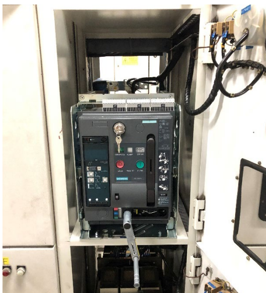
Figura 7 – Detalhe da modernização já com novo disjuntor SIEMENS 3WL (800 A) instalado no seu compartimento/cela
