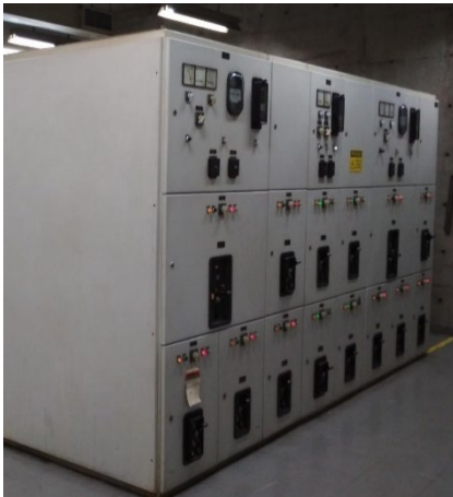
Figura 1 – Quadro Principal de Distribuição 460VCA (QPD) da estação Santa Cecília L3-Vermeha (antes da modernização)
