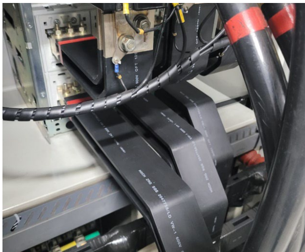
Figura 30 – Barramentos do novo disjuntor da entrada 1 instalado. Note que as furações de saída do 3WL agora estão simétricas em relação aos barramentos de distribuição (abaixo, na horizontal). Estes foram substituídos por novos barramentos
