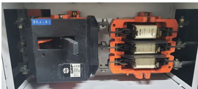
Figura 14 – QDGF: Vista da gaveta original (antiga) com seccionadora trifásica da empresa SACE Bergamo, modelo GRP-100, que não atende norma NR-10
