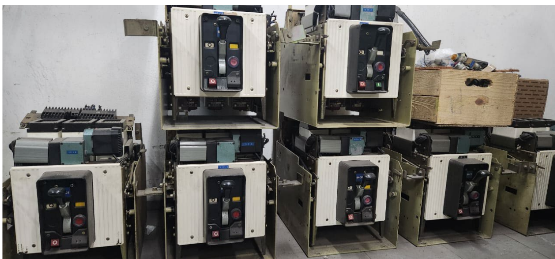
Figura 36 – Disjuntores antigos (800 amperes) que, agora, após revisão na Oficina Elétrica de Disjuntores do Pátio Itaquera, virarão sobressalentes estratégicos as Linhas 1 e 3
