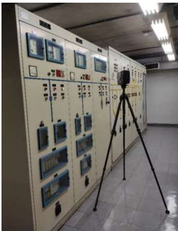
Figura 20- Escaneamento salas técnicas e trafos (Foto acervo Metrô/CDT)
