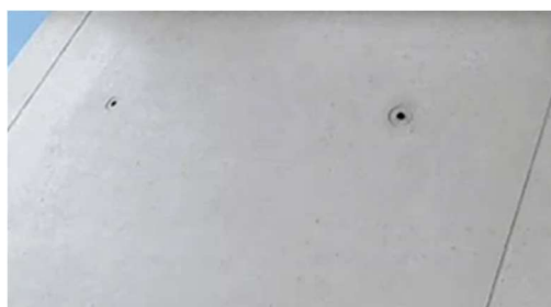
Foto 12 – Furos na parede deixados pelos cones recuperáveis
