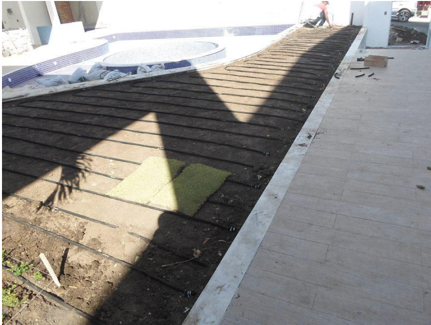
Figura 1 – Exemplo de instalação de mangueiras perfuradas, para sistema de gotejamento.
