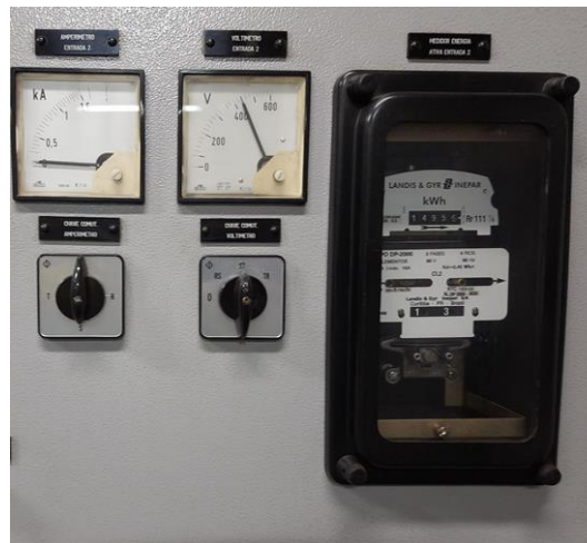
Figura 12 – Detalhes do frontal de uma cela/compartimento de painel elétrico, com medidor de energia eletromecânico antigo
