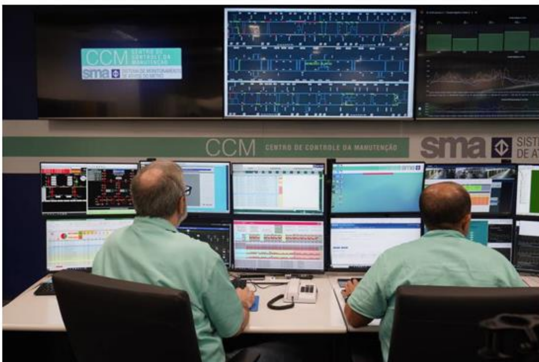
Figura 6 – Sala do SMA (Sistema de Monitoramento de Ativos) da Diretoria de Operações: DO/GMT
