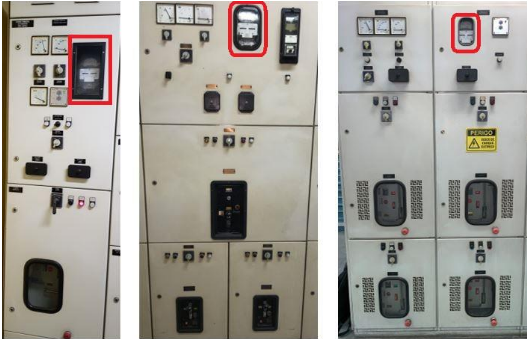
Figura 10 - Subestação Auxiliar Linha 3: Padrões H, I e J, todos da empresa Brow Boveri (BBC)
