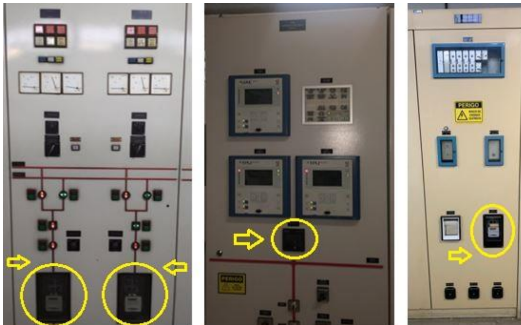
Figura 11 - Painéis de Subestações Primárias das Linhas 1, 2 e 3, respectivamente
