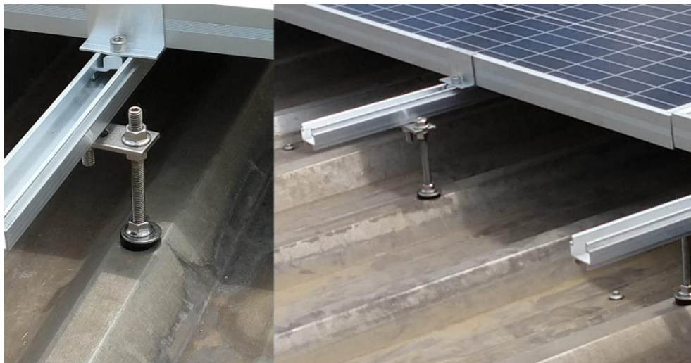
Figura 2 - Suportes para módulos solares
