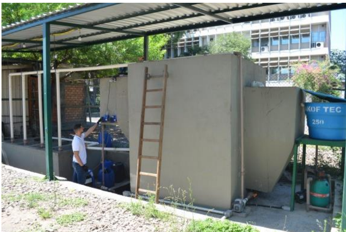
Figura 10 - Estação de tratamento de efluentes da lavagem de peças e truques em operação. Fonte: do autor.
